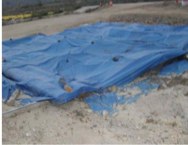
의상대교 현장 주변 철근 관리상태
